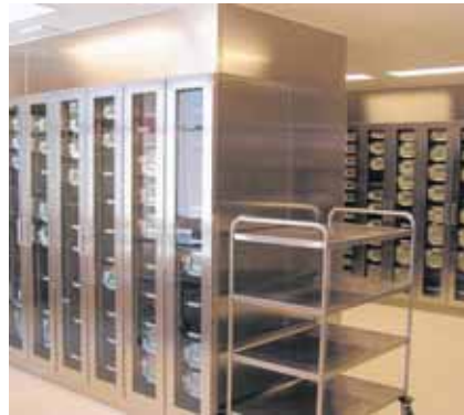
Die optimierte Sterilgutlagerung erfüllt im Bereich Hygiene und Logistik die höchsten Anforderungen.
