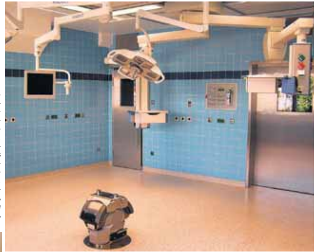
Durch die Zusammenfassung fast aller Operationen des Hauses im Zentral-OP wird die Organisation im Operationsbereich deutlich vereinfacht und sowohl personelle als auch materielle Ressourcen können noch effektiver genutzt werden.
